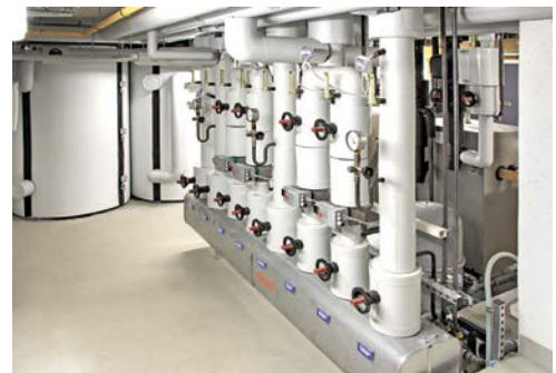
... um die Heizungsanlage optimal zu programmieren und so Energie und Kosten zu sparen
