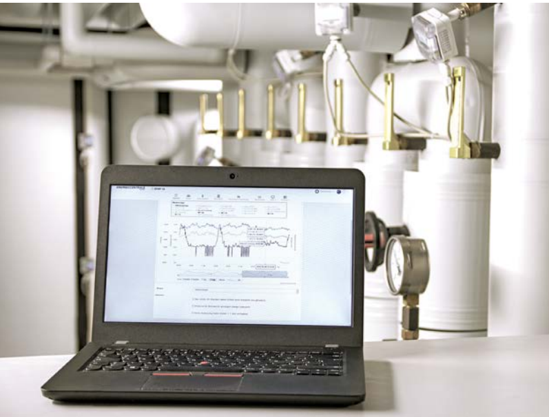
Auf dem Computer werden Daten zu Temperaturen, Energieverbrauch oder Nutzerverhalten von Heizungsanlagen visualisiert ...
